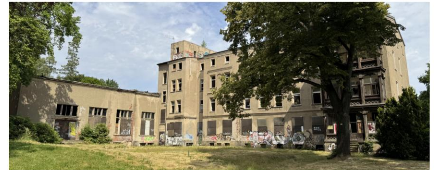
Das Kahlbaumareal in Görlitz heute. Auf dem historischen und seit einigen Jahren leerstehenden Gelände sollen zentrale Gebäude des Deutschen Zentrums für Astrophysik entstehen. Bild: con terra GmbH
